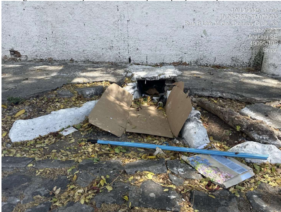
Figura 2.10 - Obstrução de boca de lobo pela disposição inadequada de resíduos sólidos.
