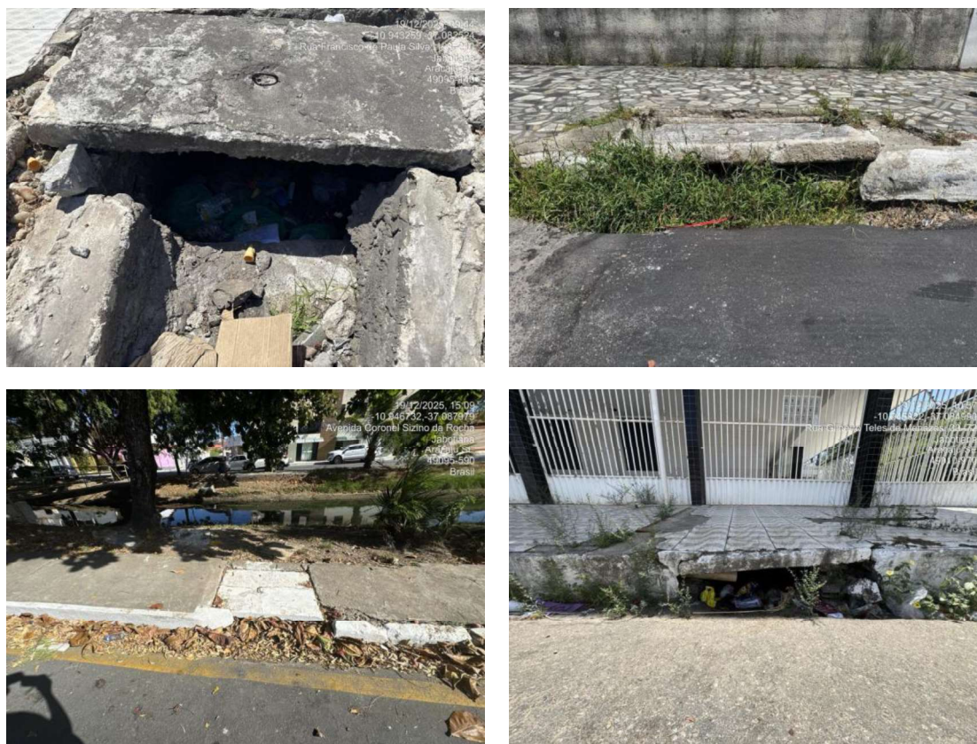
Figura 2.15 - Dispositivos de microdrenagem obstruídos em vias públicas do bairro Jabotiana.
