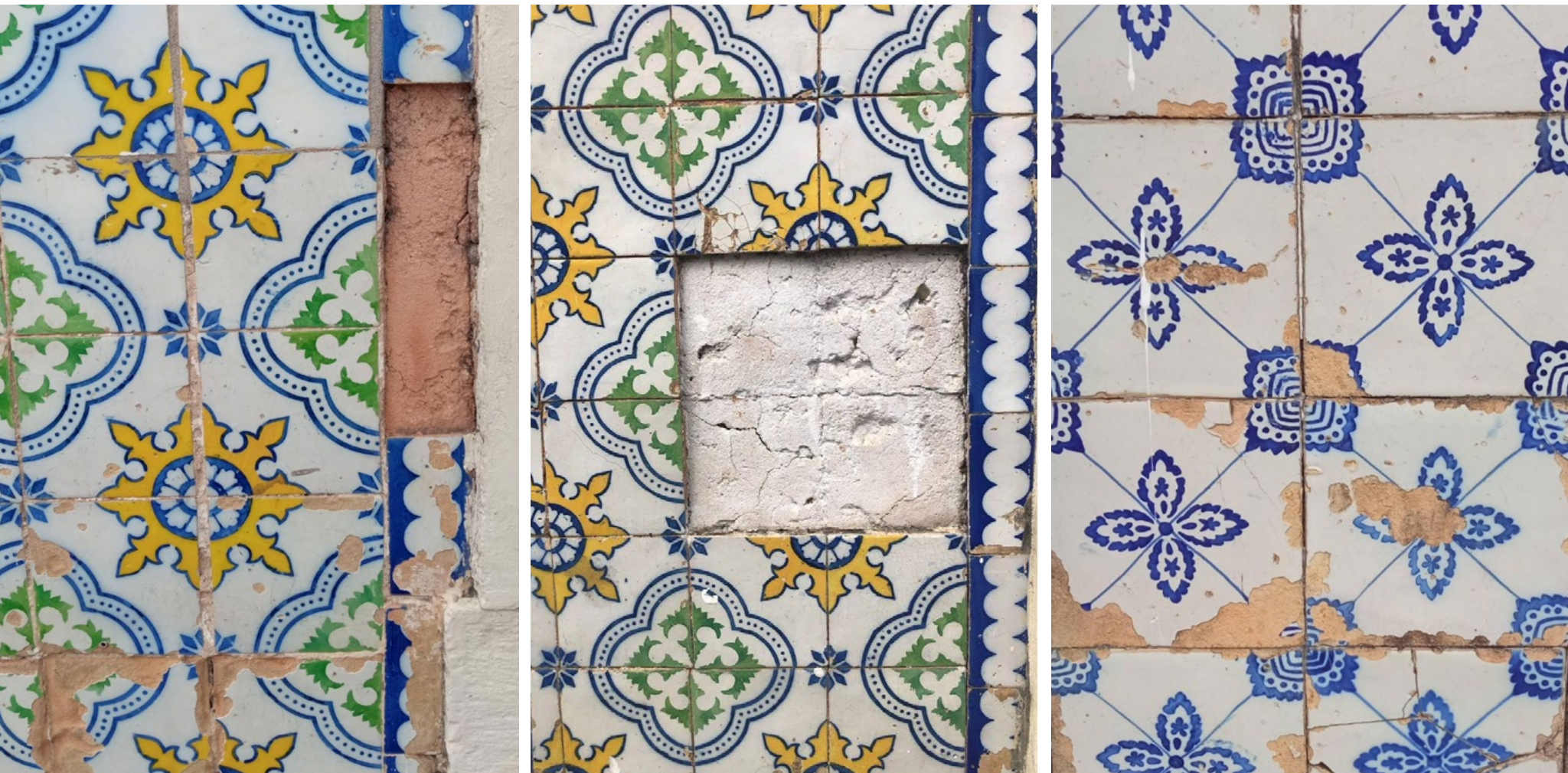
Figuras 11, 12 e 13. Danos em fachadas azulejares em Estância. Da esquerda pra direita: Edificação n.º 67 – F1, Edificação n.º 228 – F5. Fonte: Acervo pessoal da autora, 2025.
