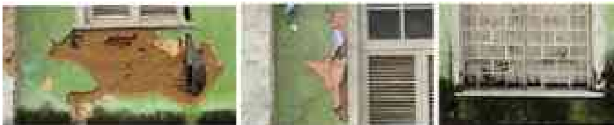
Figura 85 – Danos à edificação
