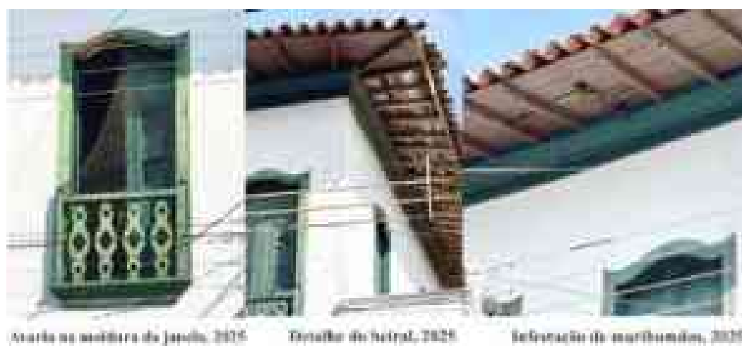
Figura 95 – Áreas em deterioração da edificação número 20
