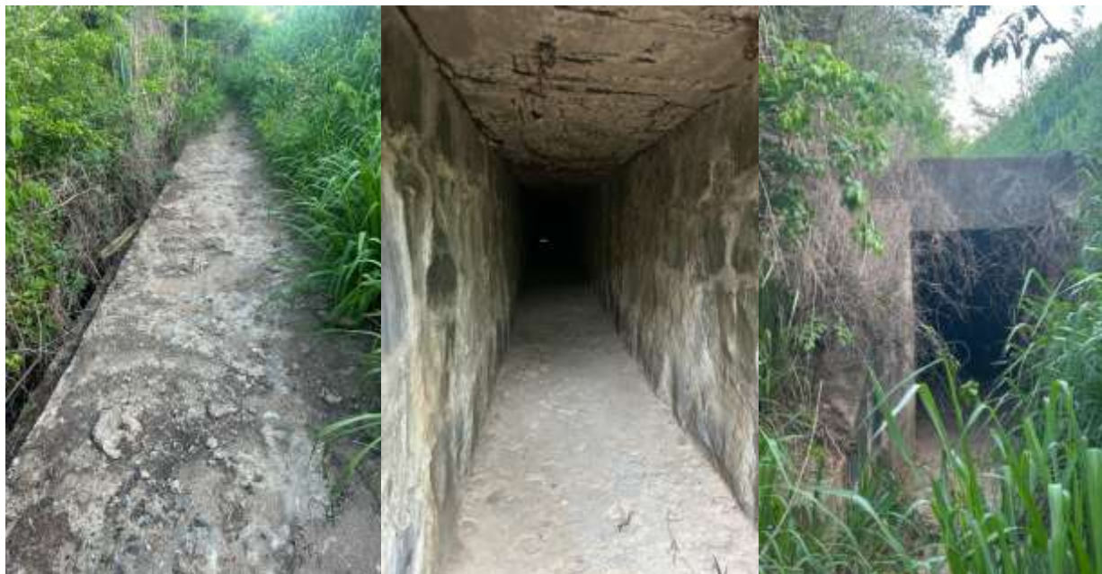
Figura 34: Bueiro entre a comunidade Cutia e Barracão.
