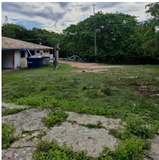
Figura 1: Vista parcial da degradação da praça de entrada
