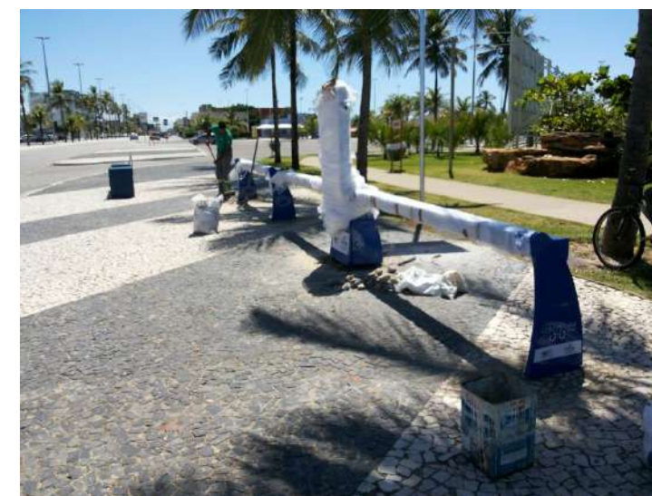
Figura 65: Instalação da Estação Oceanário do Caju Bike.
