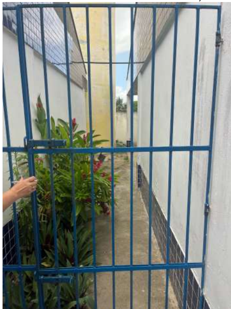
Figura 26- Área descoberta de acesso à cozinha, suscetível a chuvas
