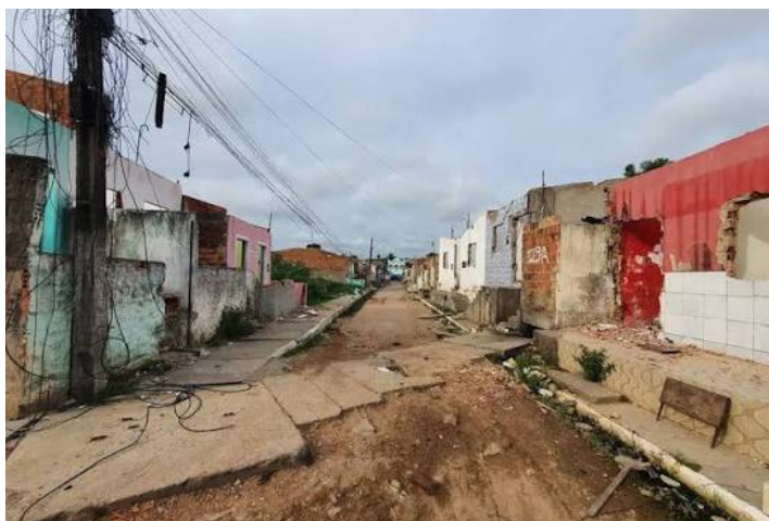
Figura 11 — As marcas destrutivas do crime socioambiental no bairro Mutange em Maceió/AL.
