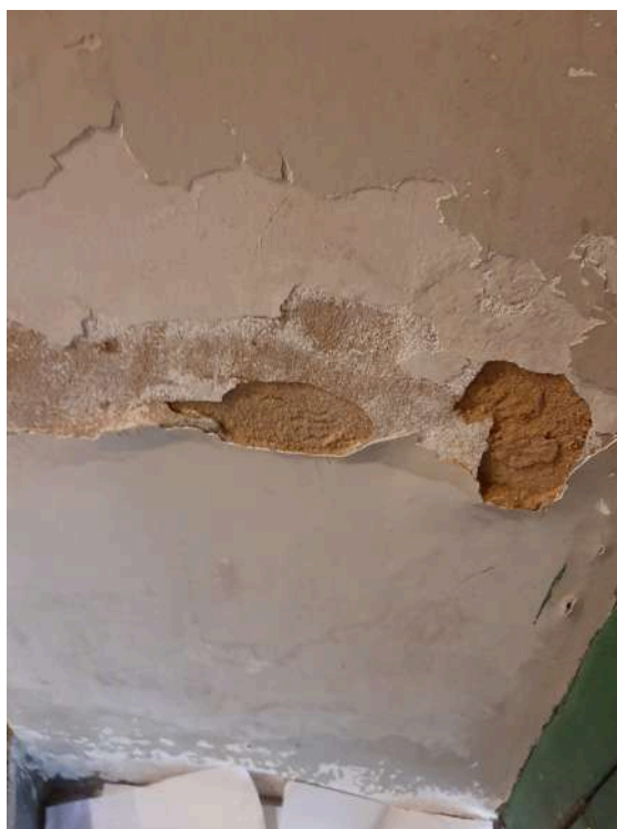
Figura 1: Patologia de descolamento em parede.
