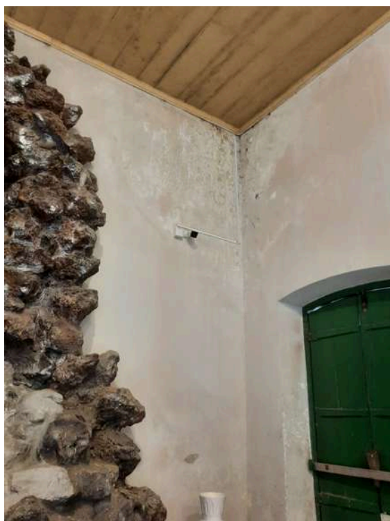
Figura 6: Exemplos de eflorescência no interior da Igreja Matriz.
