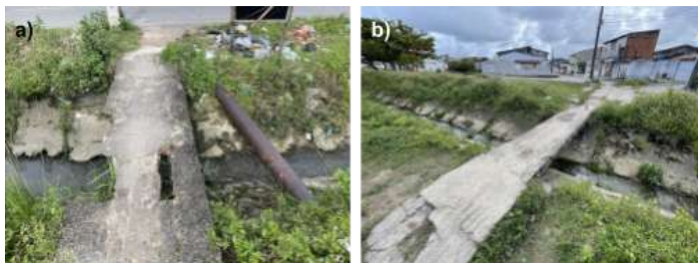
Figura 33: a) Ponte de travessia com buracos b) Ponte de travessia deteriorada
