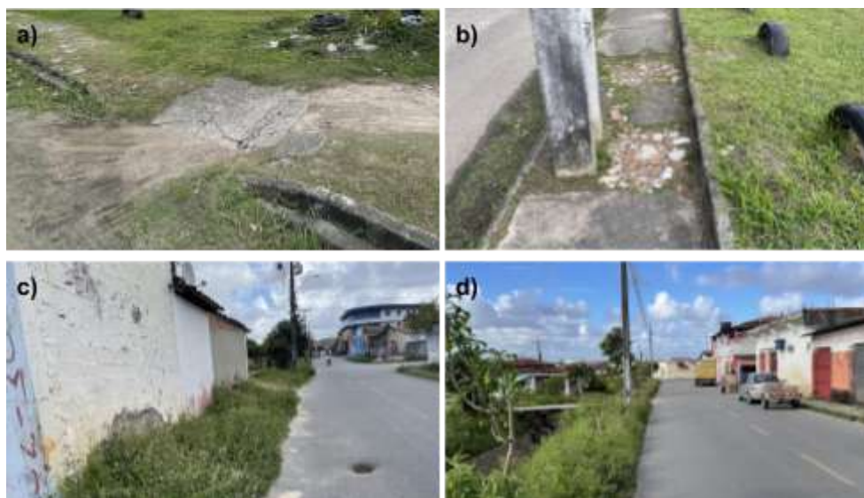
Figura 30: a) Rampa deteriorada. b) Trecho estreito de calçada c) Trecho da via sem calçada sentido sul d) Trecho da vida sem calçada sentido norte
