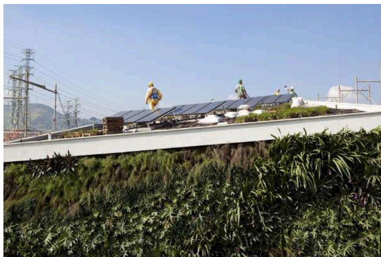
Figura 18: Instalação de placas fotovoltaicas e parede verde
