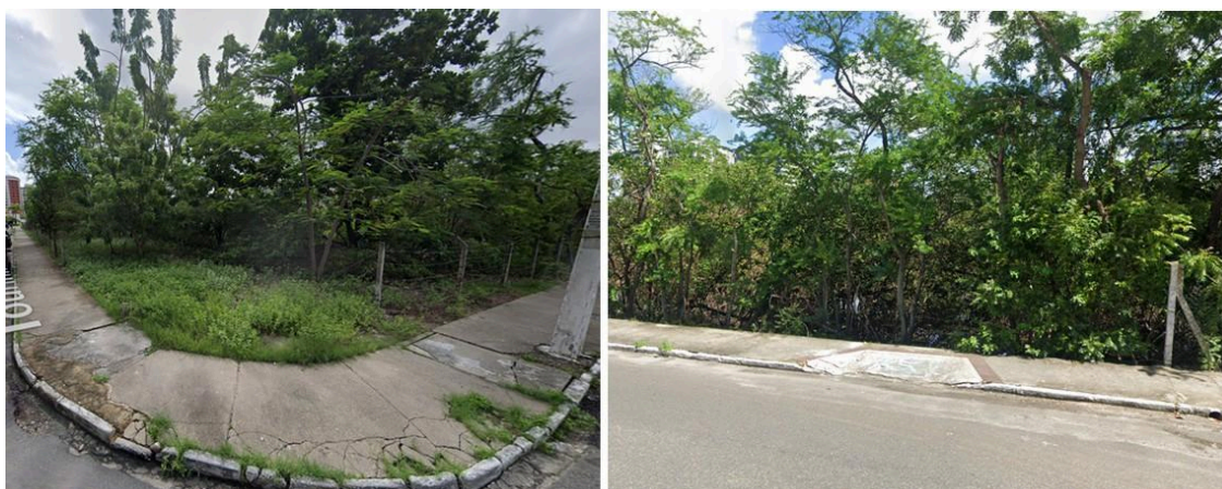
Figura 44: Passeios com largura útil insuficiente, guias rebaixadas sem largura remanescente de calçada e com pavimentação degradada.
