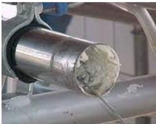
Figura 14: Tubulação com resíduos de leite coalhado.
