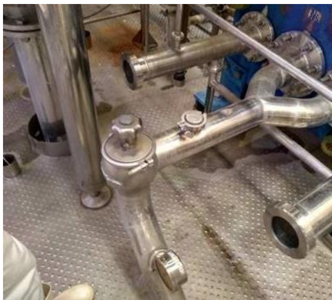
Figura 16: Junção de linhas de forma inadequada, dificultando a limpeza individual.
