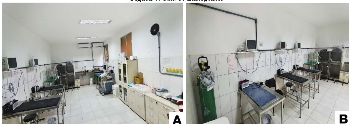
Figura 7: Sala de Emergência
