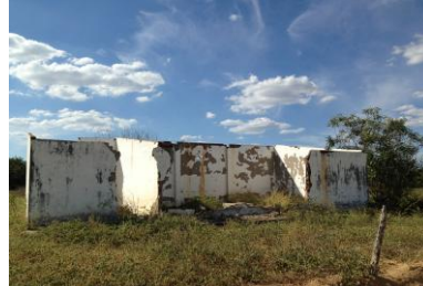
Figura 5 - Ruínas da Escola Municipal Rui Barbosa
