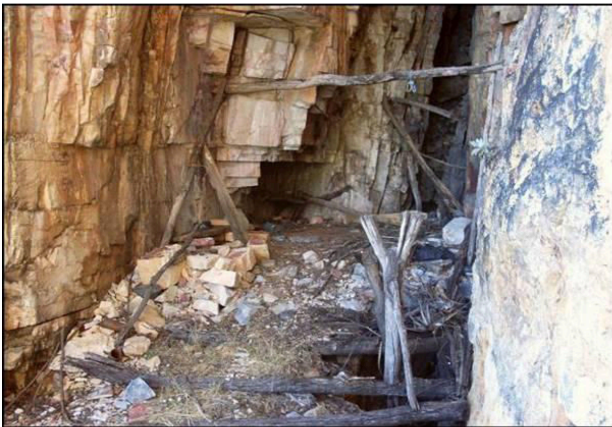
Figura 36 – Estrutura de garimpo abandonada junto à escarpa da Serra Grande
