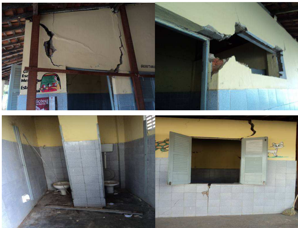
Figura 22: Condições precárias das Escolas das comunidades do entorno do RVSMJ
