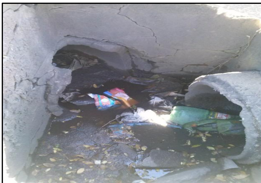
Figura 4.3: Ligação de esgoto na rede de drenagem e a presença de resíduos sólidos, Aracaju/SE (13/07/2014). Fonte: O Autor
