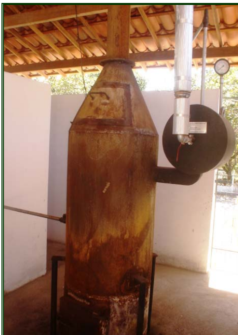
Figura 22 - Forno da mini-fábrica . Com. Caiana, Barreira/Ce. Fonte: o autor, 2006.
