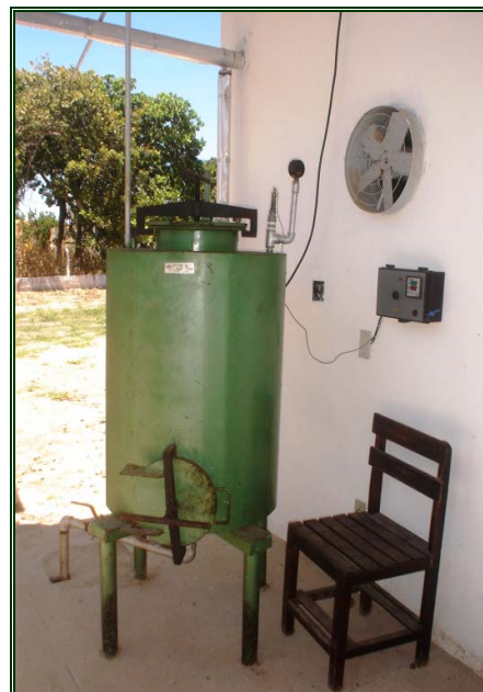
Figura 21 – Caldeira da mini-fábrica. Com. Caiana, Barreira/Ce. Fonte: o autor, 2006.
