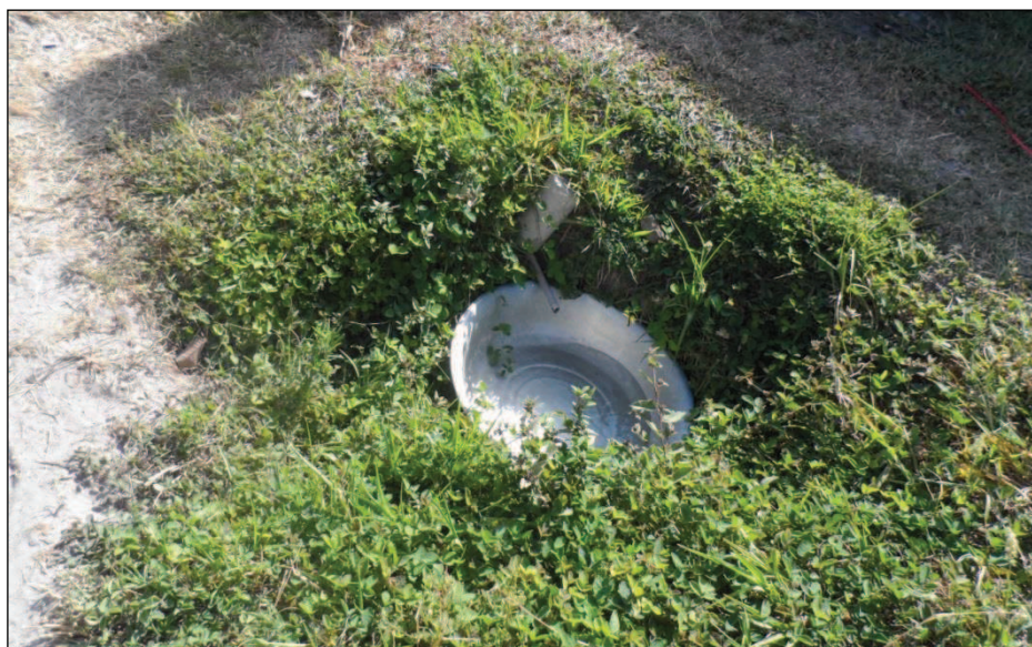
Figura 38 - Povoado Terra Caída- Abastecimento de Água precário
