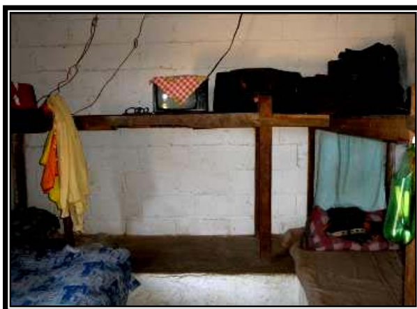
Fotografia 17: Local onde os trabalhadores dormem com rede elétrica exposta, colocando vidas em risco.
