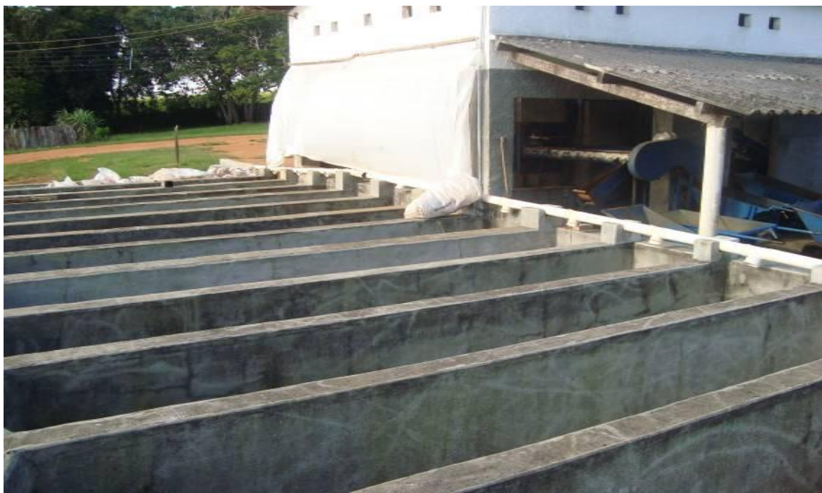
Figura 17 - TANQUES DE DEGOMAGEM DE CAFÉ E RECICLAGEM DE ÁGUA – GRANDE PROPRIEDADE / BARRA DO CHOÇA, 2010
