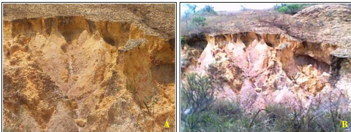
Figura 53 A e B. Erosão às margens da rodovia SE-218, no município de Estância.
