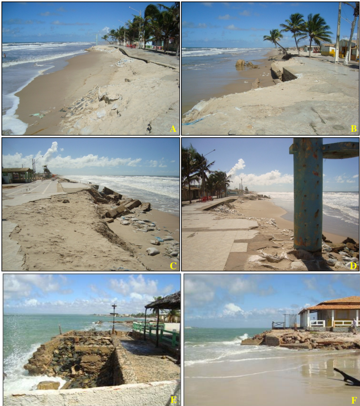
Figura 79 A, B, C, D, E e F. Erosão praial – praia do Abaís (A, B, C e D) e praia do Saco (E e F).
