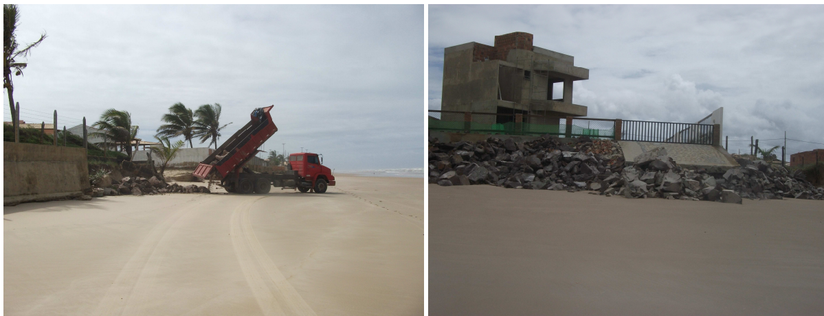
Figura 50 - Tentativa de contenção a erosão em casas de veraneio. Crédito: Emerson Alves Ribeiro, 2010.
