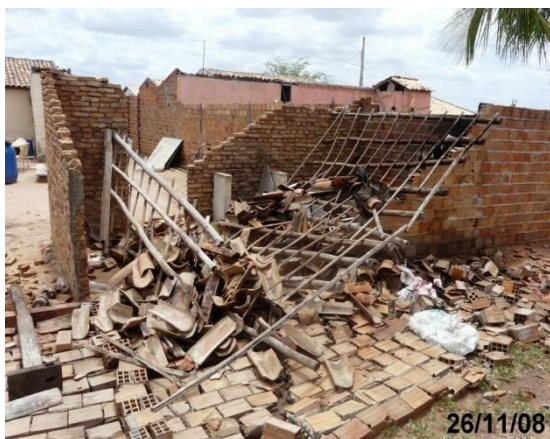
Figura 9: Muro de casa destruído pela ação do vento e chuva de granizo no povoado Lagoa do Junco, 2008. Fonte: Prefeitura Municipal, 2012. Organização: OLIVEIRA, A. R.
