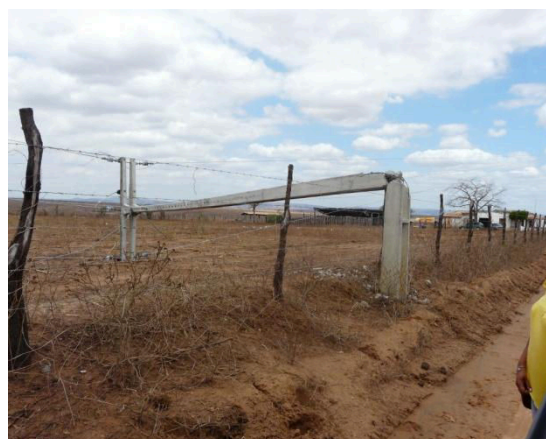
Figura 10: Poste de energia destruído pela ação do vento e chuva de granizo no povoado Lagoa do Junco, 2008. Fonte: Prefeitura Municipal, 2012. Organização: OLIVEIRA, A. R.
