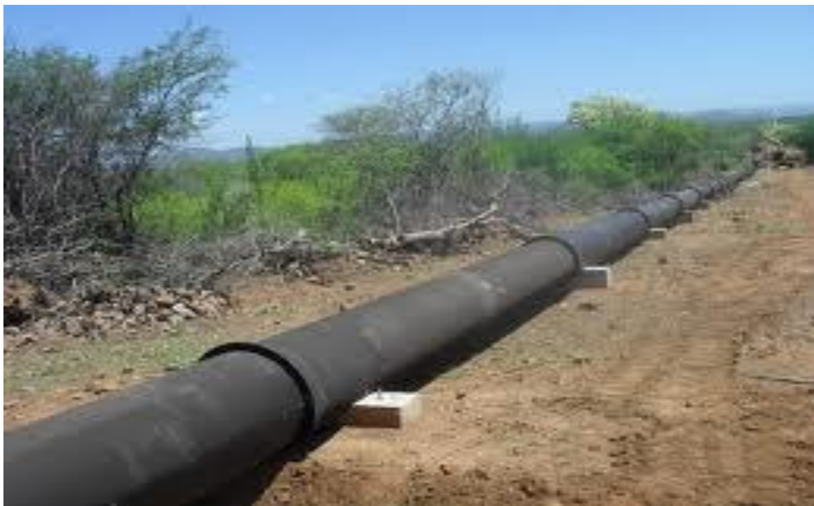
Figura 24: Trecho aéreo da adutora Sertaneja no município de Amparo do São Francisco/SE. Fonte: SOUSA SILVA, Luiz Carlos. 2012.
