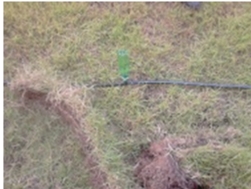
Figura 4 – Aspersor Pet instalado.
