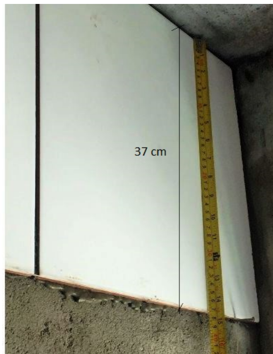
Figura 11 – Pré-condição inadequada - parte 2.
