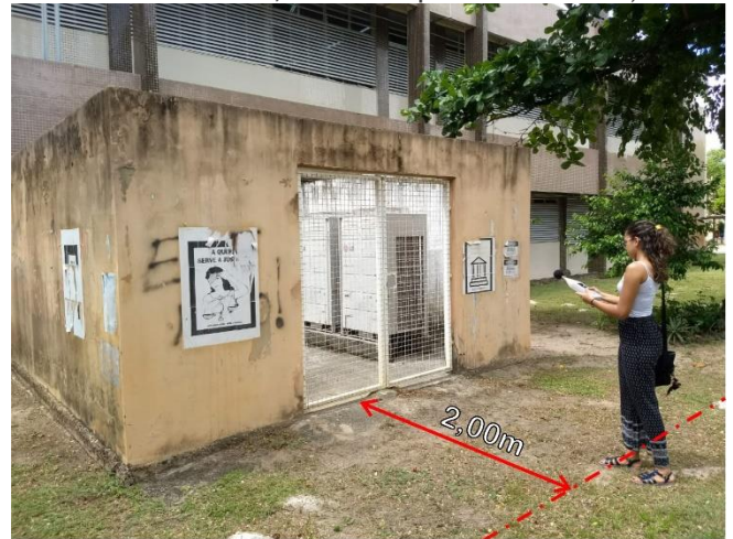
Figura 22 - Medição para caracterização acústica de fonte pontual (grupo de compressores de ar condicionado). Destaque para a posição do sonômetro a 2,00m de superfície vertical).
