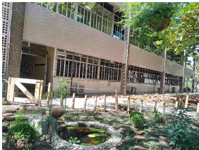
Figura 36 - Fachada sul da Did. II com compressores de ar condicionado espalhados
