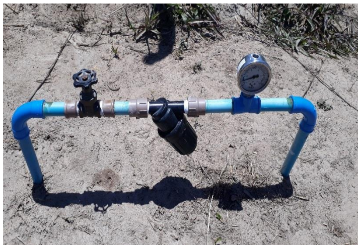
Figura 11 - Cavalete de tomada de água com registro de gaveta e manômetro analógico - São Cristóvão - SE, UFS, 2019
