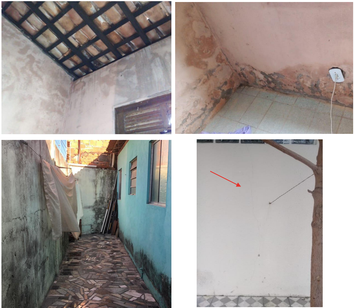
Figura 79 – Manifestações patológicas nas habitações autoconstruídas
