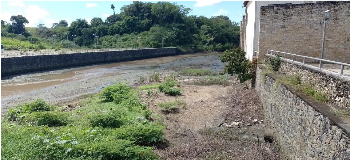
FIGURA 36 – Bueiro e assoreamento ao lado da Universidade Federal em Laranjeiras/SE.
