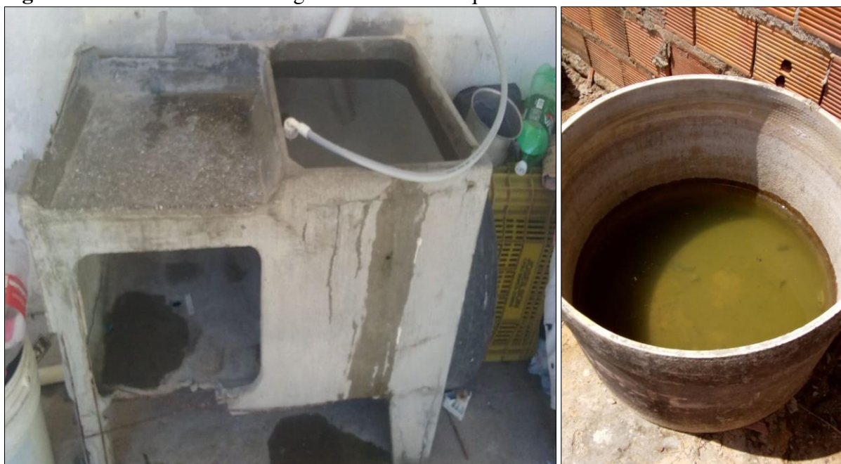
Figura 5 - Armazenamento de água de forma inadequada
