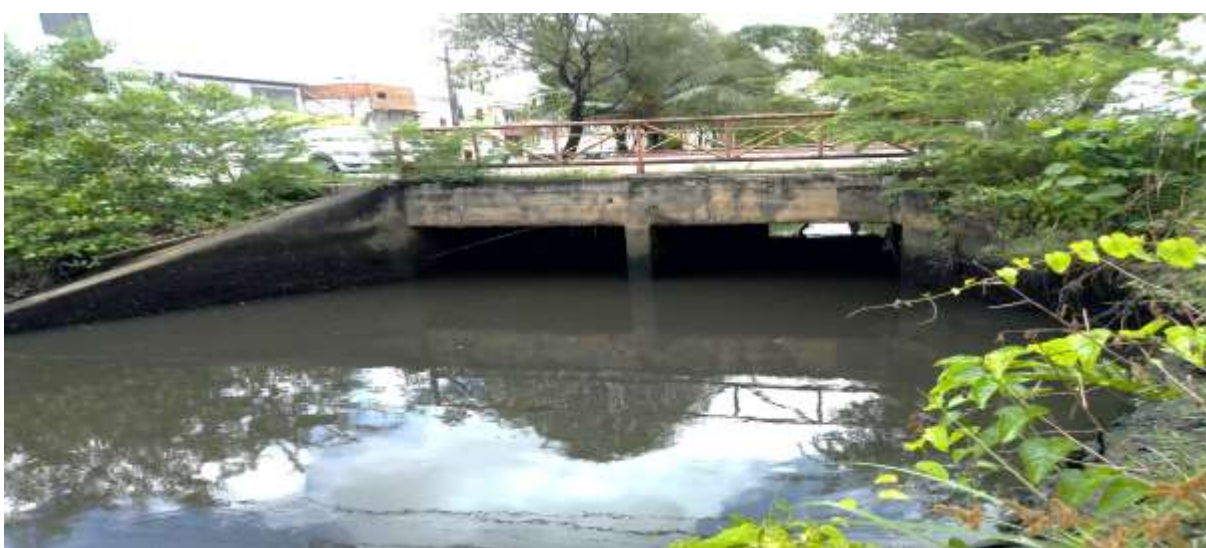
Figura 5.10 - Imagem de despejo de esgoto no rio Poxim por um canal no conjunto Santa Lúcia. Fonte: Pesquisa direta do autor (2022)
