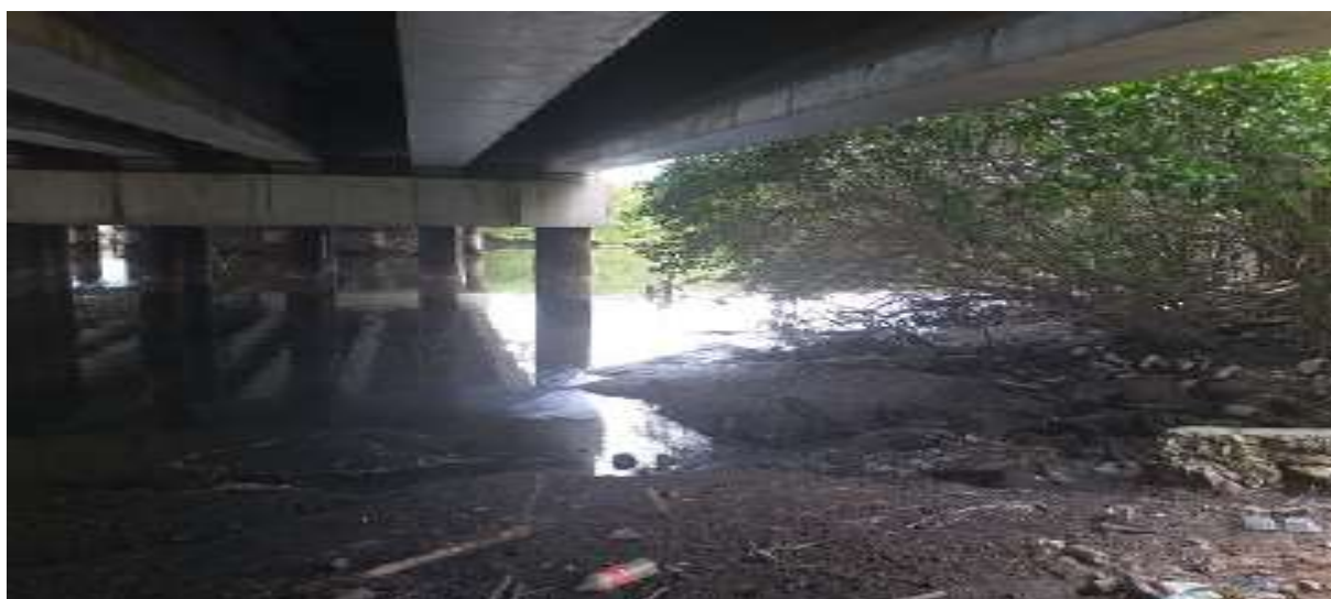
Figura 4.6 - Imagem do Relatório de Fiscalização da SPU/SE no rio Poxim.
