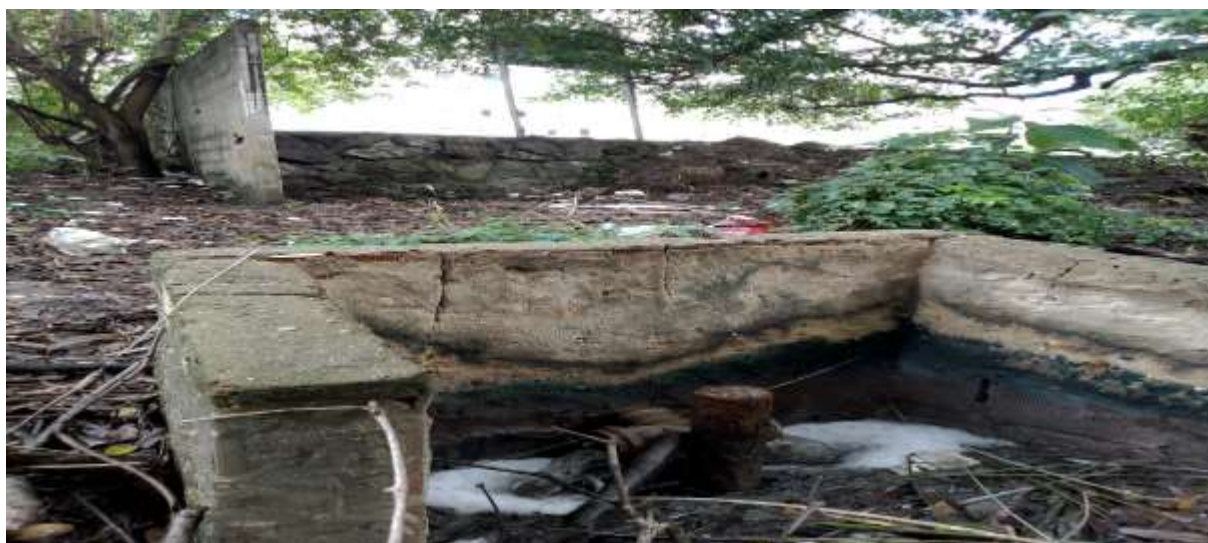
Figura 5.7 - Imagem de despejo de esgoto no rio Poxim próximo ao Condomínio Vila Verde no bairro Jabotiana.
