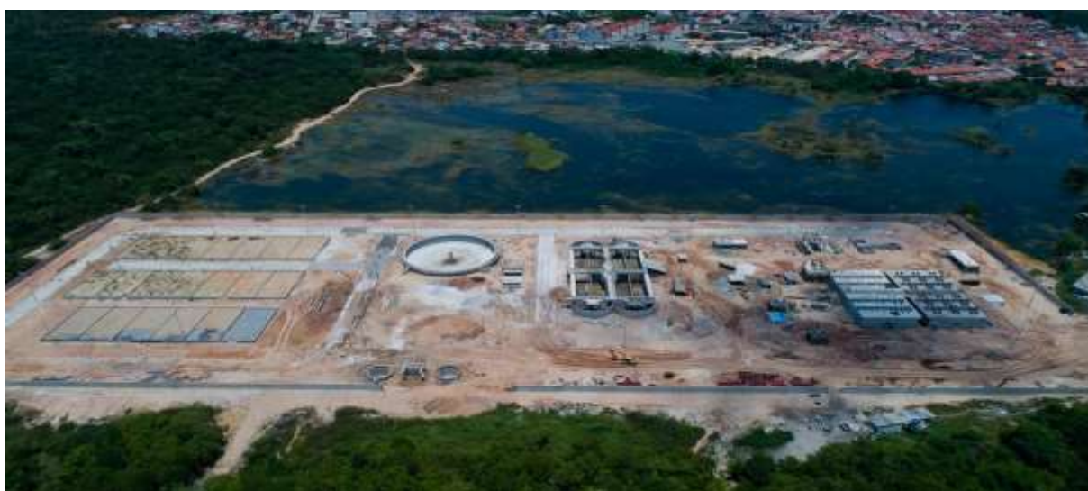
Figura 3.10 - Estação de Tratamento de Esgoto do bairro Jabotiana.
