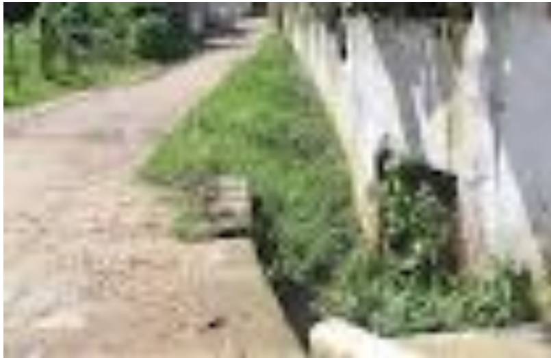
Figura 3: Esgoto a céu aberto
