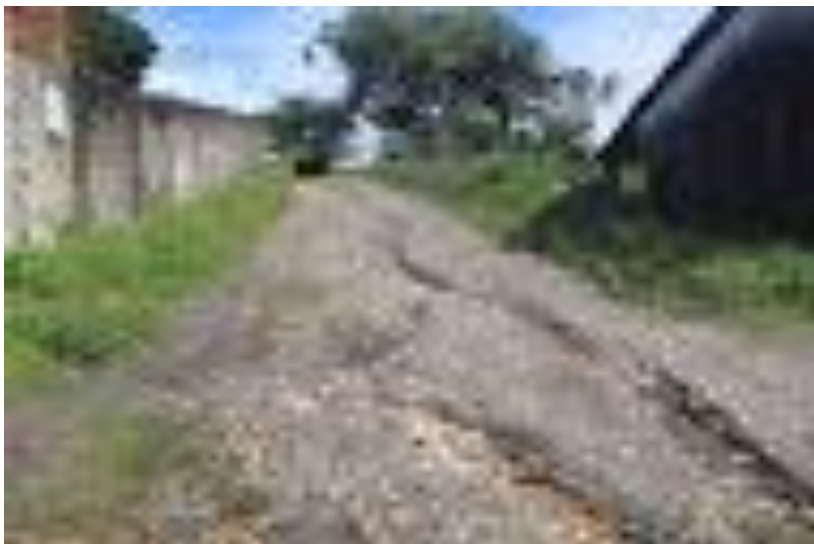
Figura 2: Rua pavimentada, porém, muito degradada
