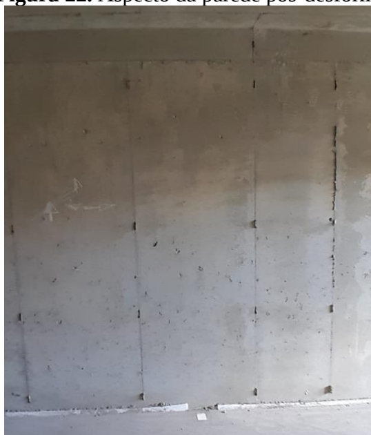
Figura 22. Aspecto da parede pós-desfôrma
