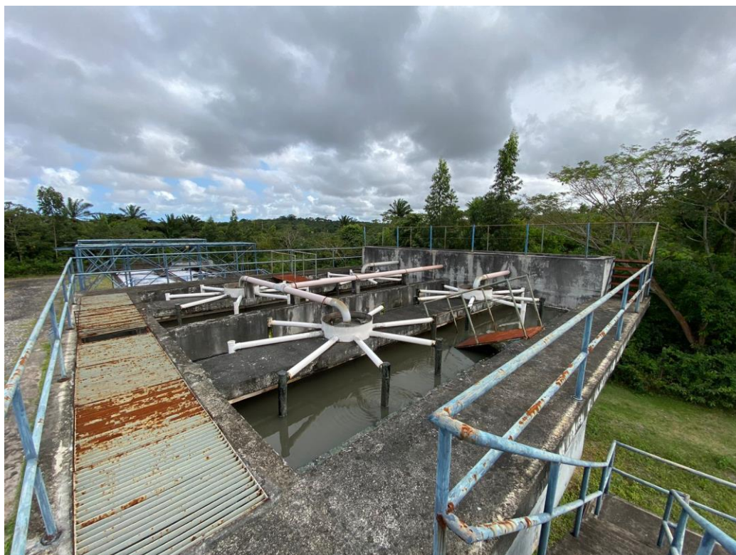
Figura 12 -Vista superior dos reatores UASB da ETE da UFS.
