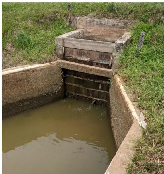
Figura 54 - Comporta de distribuição de água na região.
