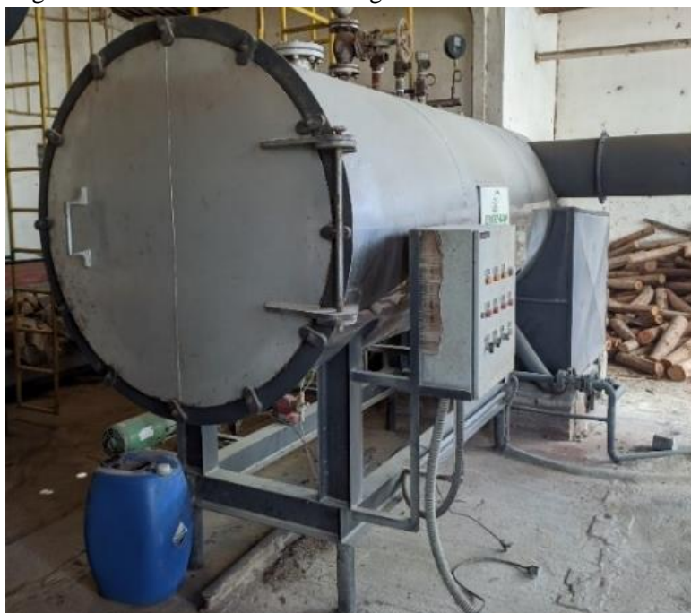
Figura 33 - Caldeira utilizada na agroindústria de beneficiamento
