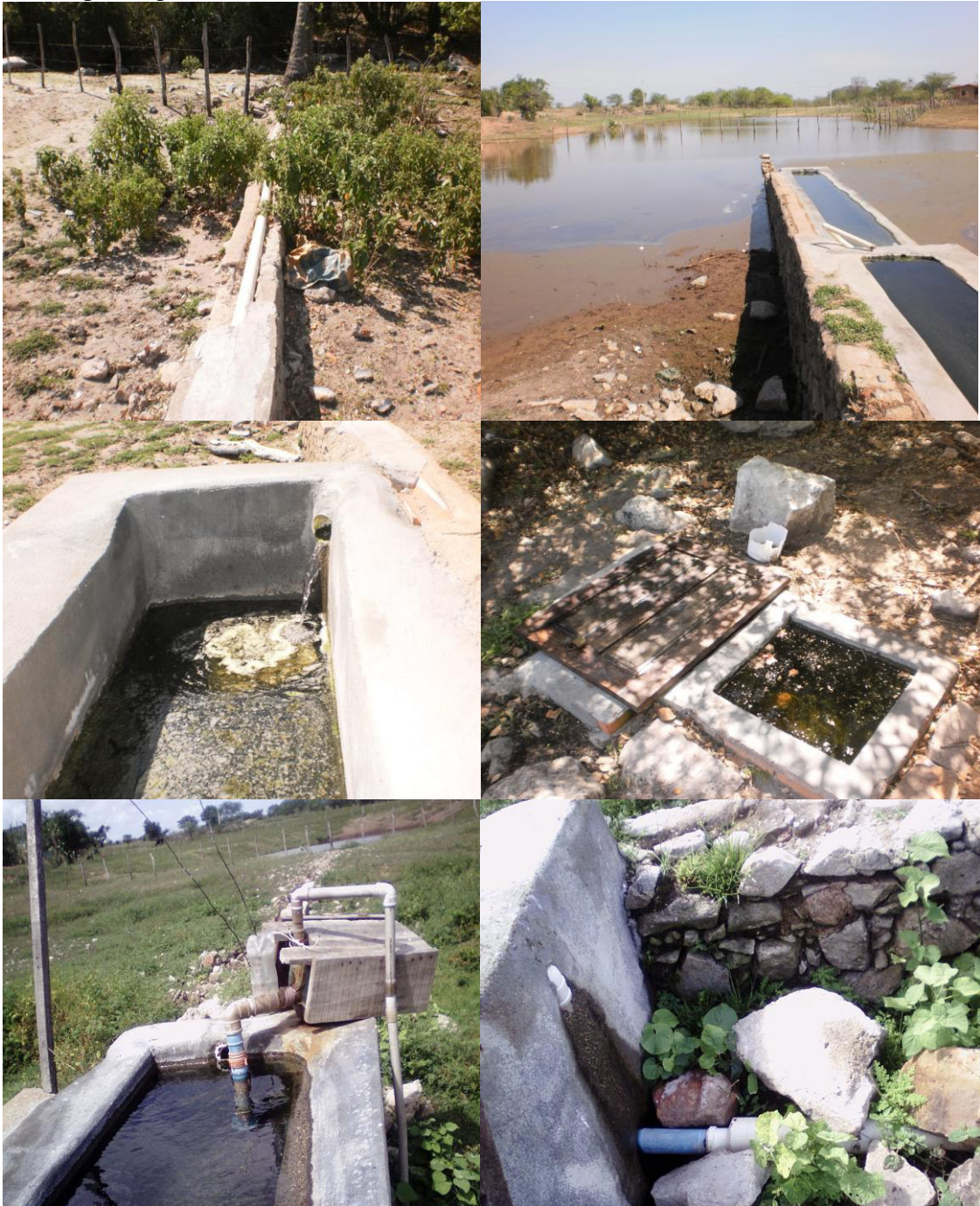
Figura 42: Encanações para transporte insustentável da água no Parque Natural Municipal Lagoa do Frio.
