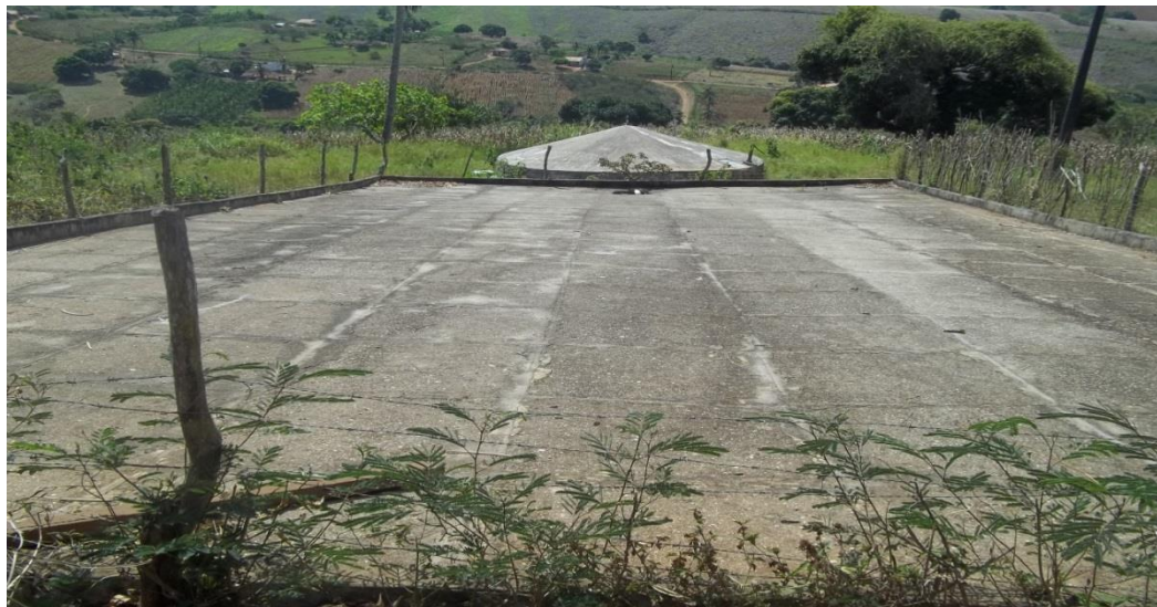
Figura 56 - Representação da cisterna de 52 Mil litros com calçada Sítio Alto município de Simão Dias Estado de Sergipe
