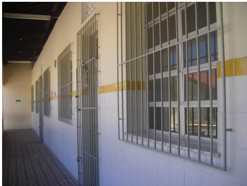
Figura 6 – Janelas e portas gradeadas com cadeados nas salas de aula da EMEF Presidente Vargas
