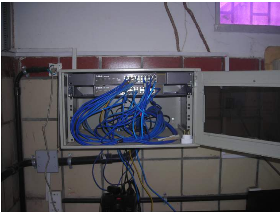
Figura 29 – Detalhe do bastidor de roteadores wireless na EMEF Juscelino Kubitschek
