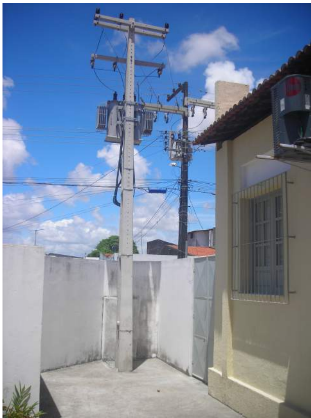
Figura 23 – Infraestrutura da entrada de energia da EMEF Presidente Vargas
