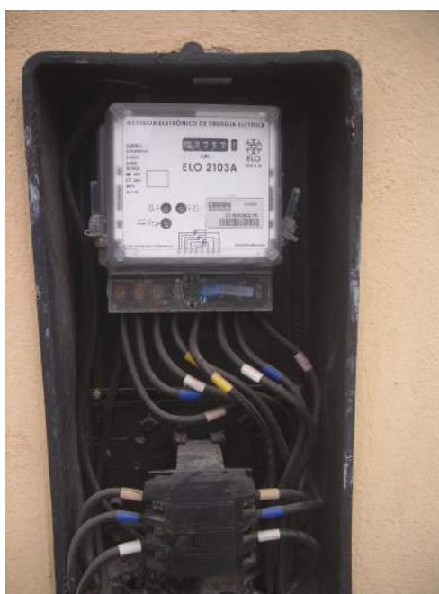
Figura 26 – Quadro de entrada de energia do prédio 2 da EMEF Santa Rita de Cássia
