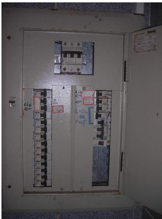
Figura 27 – Quadro de distribuição interna de energia do prédio 2 da EMEF Santa Rita de Cássia
