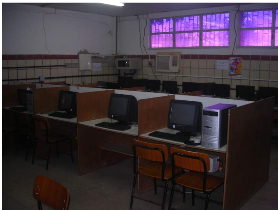
Figura 28 – Laboratório de informática com bastidor de roteadores wireless na EMEF Juscelino Kubitschek
